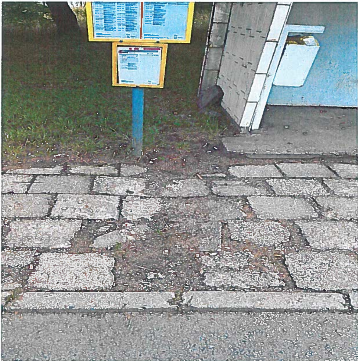
Zustand an Bushaltestelle Dabendorf, → Fahrgastinformation
